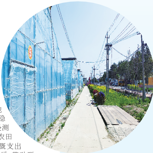
钢结构半温棚排列整齐。
